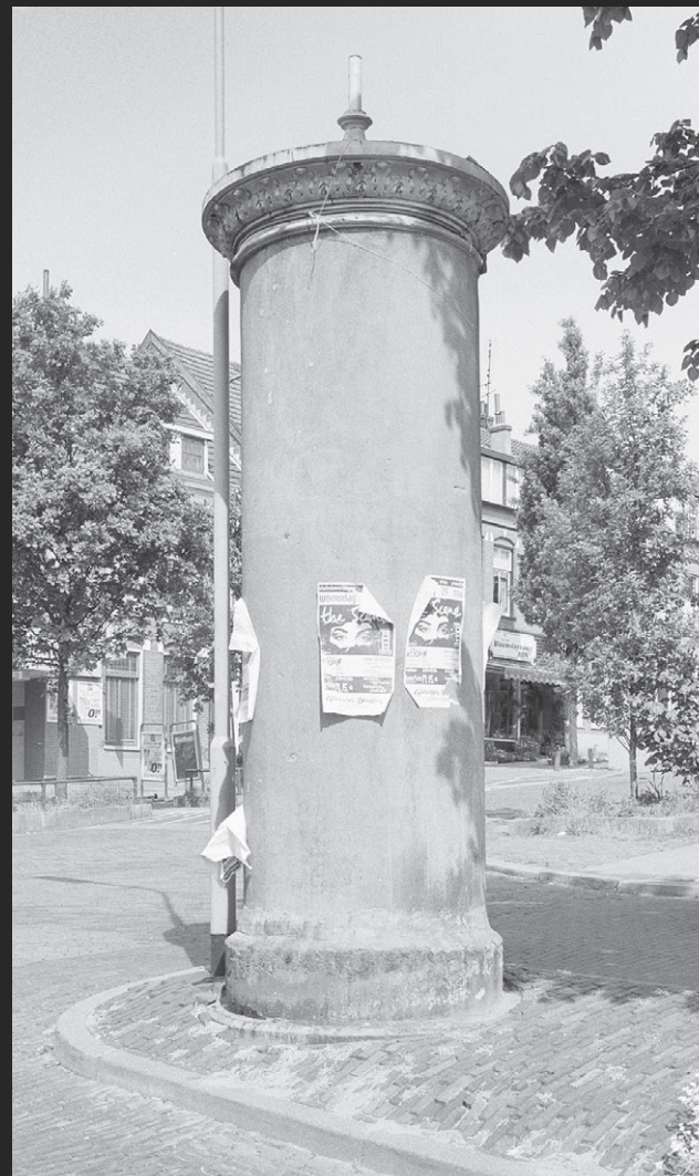
AFBEELDING: Een betonnen transforma- torzuil aan de Nassastraat Bron: RCE; 324.059
