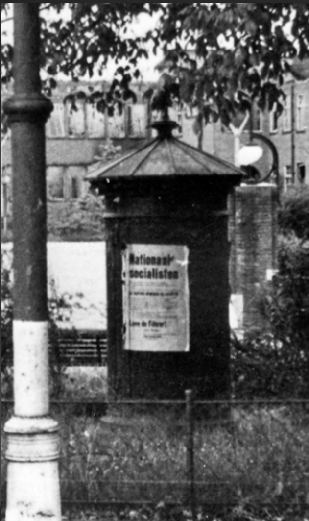
AFBEELDING: Een transformatorzuil in de Van Lawick van Pabststraat Bron: GA; 1560_5578
